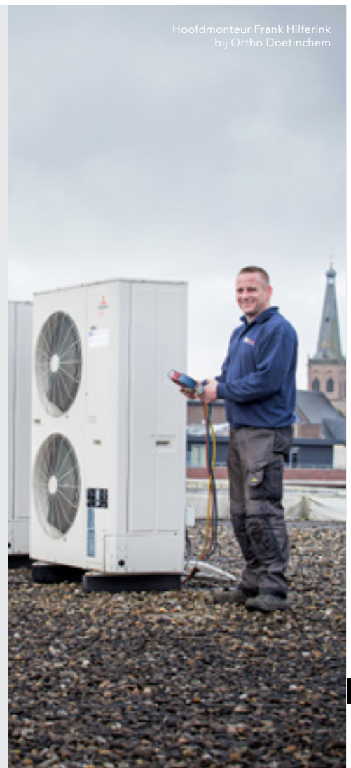
De klimaatinstallatie bij Ortho Doetinchem is weggewerkt in houten panelen
